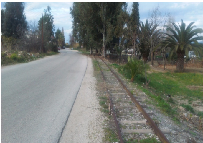
Εικόνα 5.3: Υφιστάμενη Κατάσταση της Οδού Αιγίου (3) (Ναύπλιο) Πηγή: Προσωπικό Αρχείο, 2016
