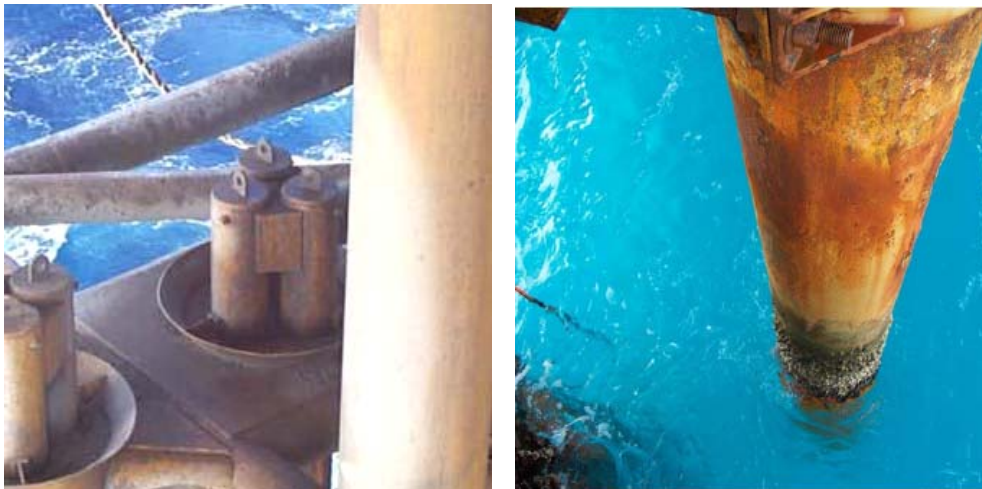
Σχήμα 1.2: Διάβρωση υπεράκτιων κατασκευών ( Corrosion of offshore structures )
