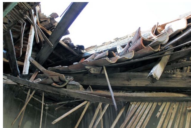
Κατάρρευση τμήματος στέγης
