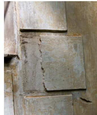
Αποσάθρωση της επίπλαστης κατεργασίας
