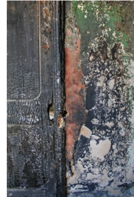
Καταστροφή κουφωμάτων των εσωτερικών ανοιγμάτων
