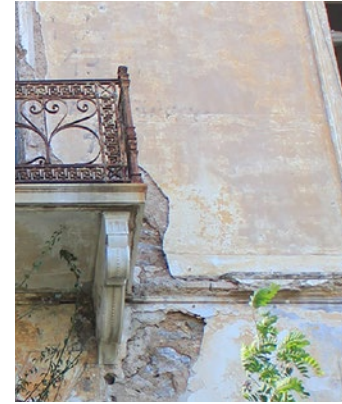
Αποσάθρωση της περιμετρικής διακοσμητικής ταινίας
