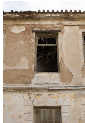
Αποσάθρωση επιχρισμάτων και διακοσμητικών πλαισίων των ανοιγμάτων
