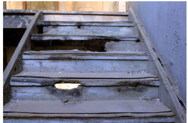
Αποσάθρωση πατημάτων κλίμακας και αποκόλληση από την τοιχοποιία
