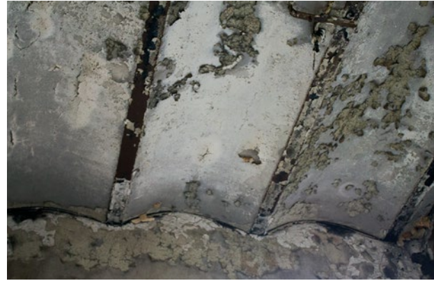
Οξειδωση Σιδηροδοκών της πλάκας του ισογείου
