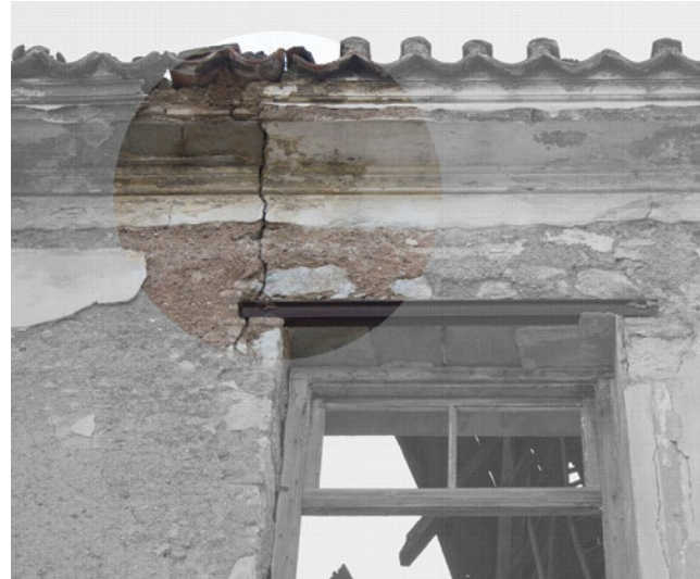
Ρηγμάτωση Εξωτερικής Τοιχοποιίας
