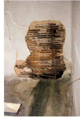
Κατάρρευση τμημάτων της οροφής
