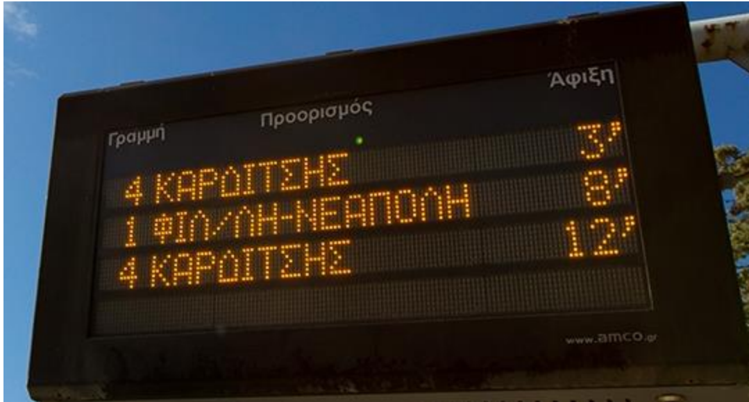
Εικόνα 21: Πίνακας τηλεματικής για την ενημέρωση διέλευσης των αστικών λεωφορείων
