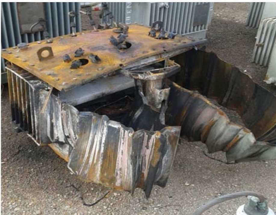
Εικόνες 3.5.1-1: Μετασχηματιστής τάσης ύστερα από κεραυνοπληξία.
