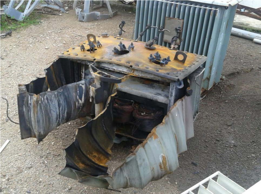
Εικόνες 3.5.1-2: Μετασχηματιστής τάσης ύστερα από κεραυνοπληξία. Φαίνονται τα πηνία καμένα στο εσωτερικό.
