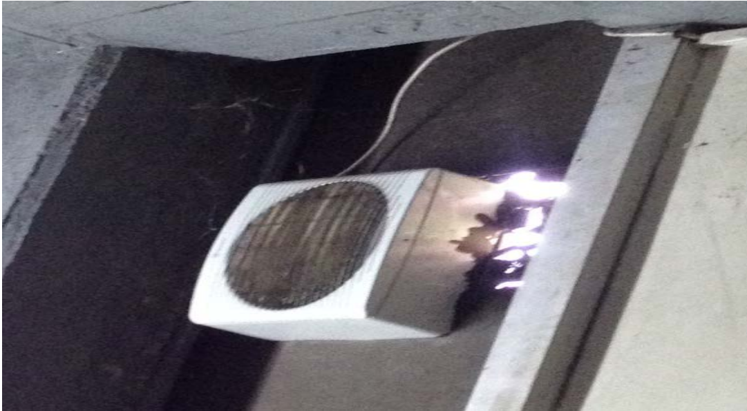
Εικόνα 3.18: Εξαεριστήρας στο χώρο της δεξαμενής
