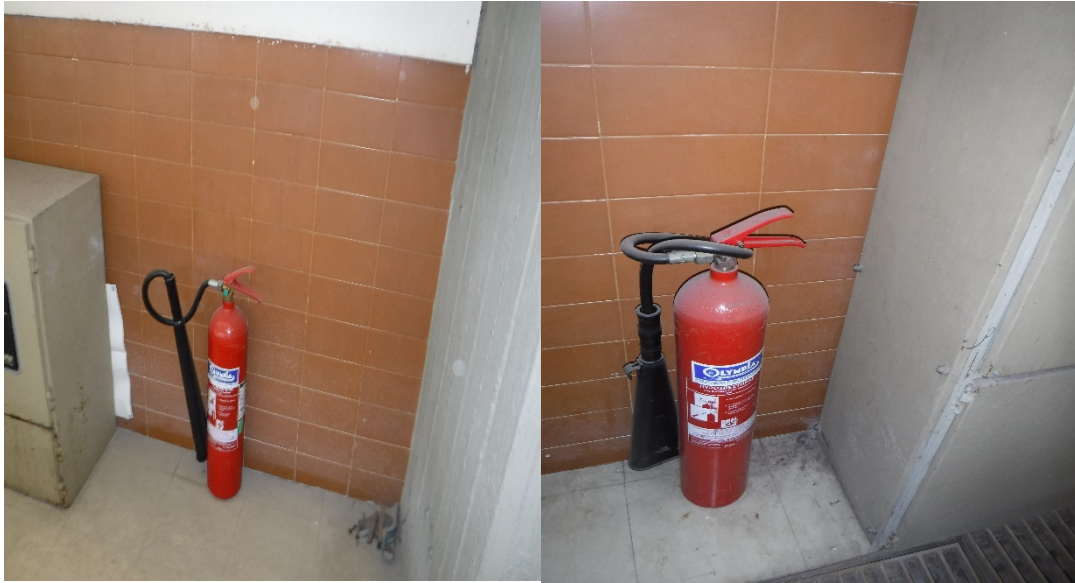
Εικόνα 4.34: Λάθος τοποθέτηση πυροσβεστήρων
