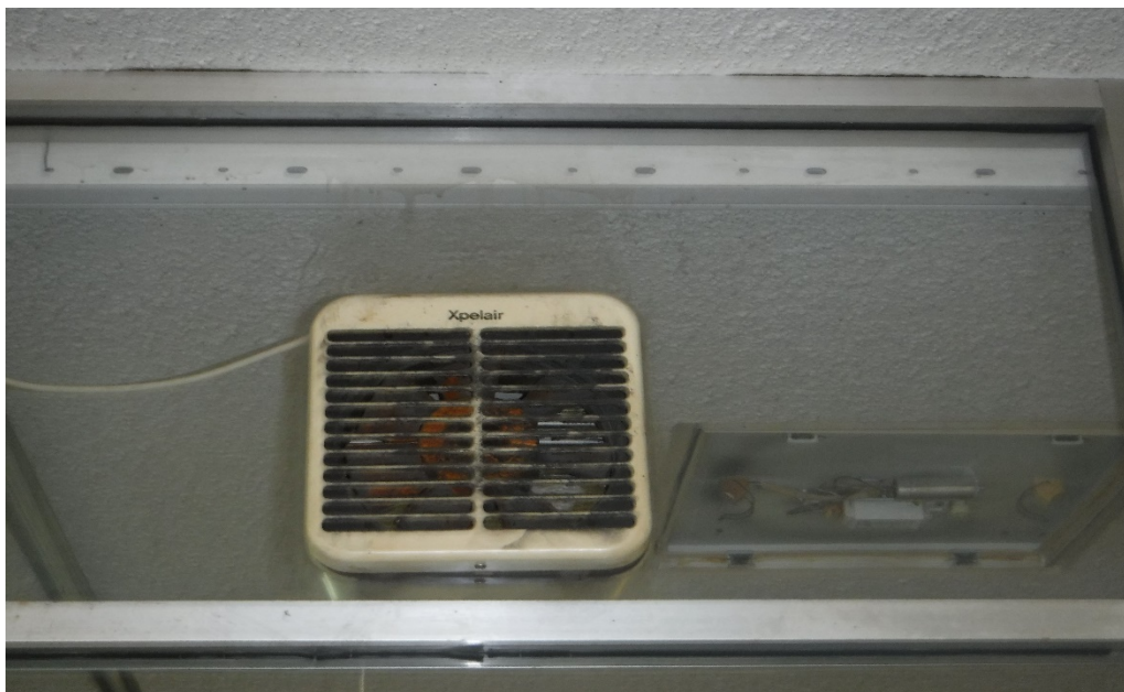
Εικόνα 3.19: Εξαεριστήρας σε γραφείο εργαζόμενου εργαστηρίου
