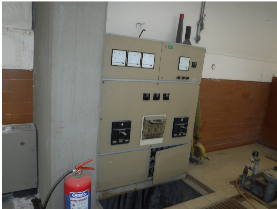
Εικόνα 4.12: Πίνακας ασφάλειας με άνοιγμα δαπέδου μπροστά από αυτόν.
