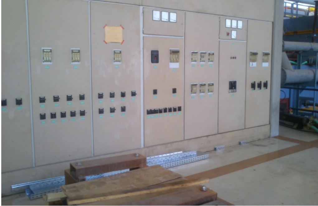
Εικόνα 4.22: Πίνακες υψηλών τάσεων
