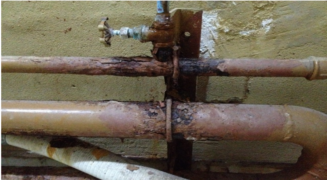
Εικόνα 3.17: Διάβρωση σωληνώσεων θέρμανσης λόγω διαφορετικού υλικού των σωληνώσεων και του σάτη στήριξης
