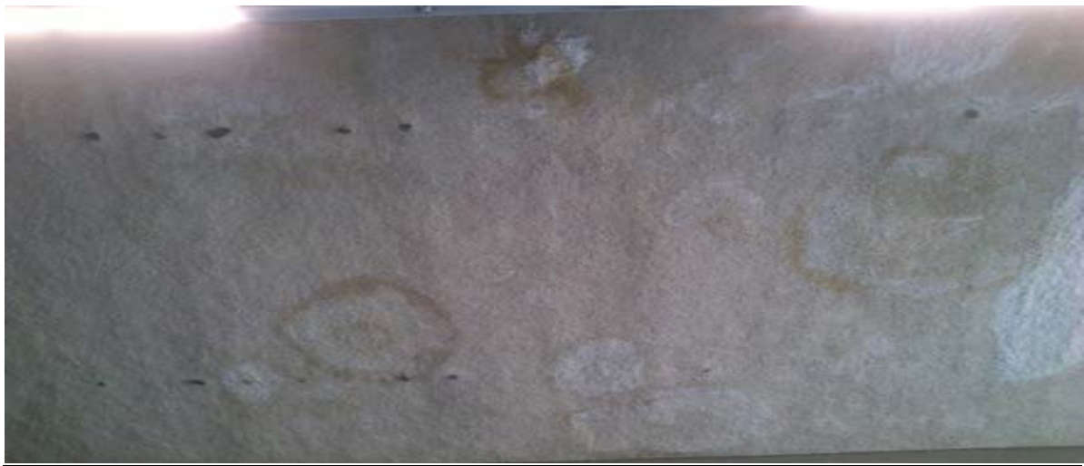
Εικόνα 4.16: Ενδείξεις υγρασίας και πτώσης σοβάδων στην οροφή του εργαστηρίου
