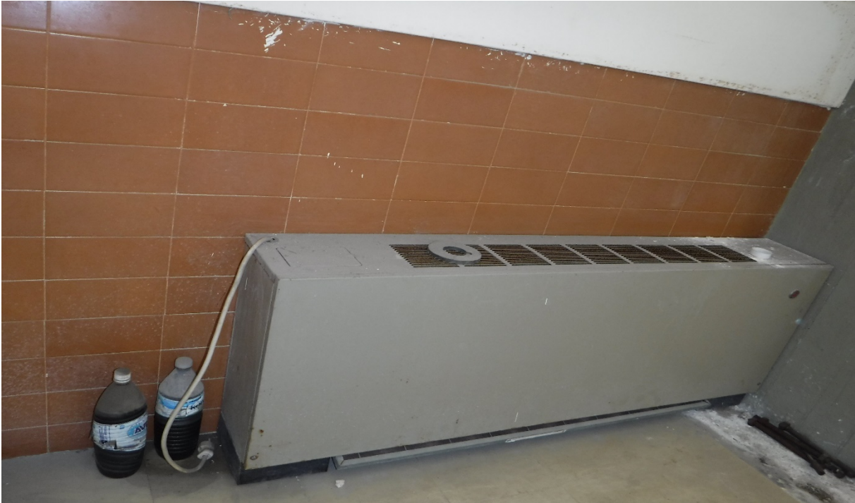
Εικόνα 4.3: Δοχεία γεμάτα με αγνώστων στοιχείων υγρό δίπλα σε μηχανισμό θέρμανσης.
