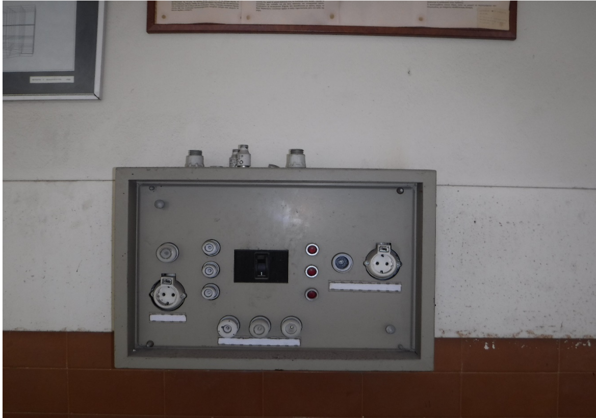
Εικόνα 4.11: Ηλεκτρικός πίνακας χωρίς προστατευτικό κάλυμμα και με καμένη ασφάλεια
