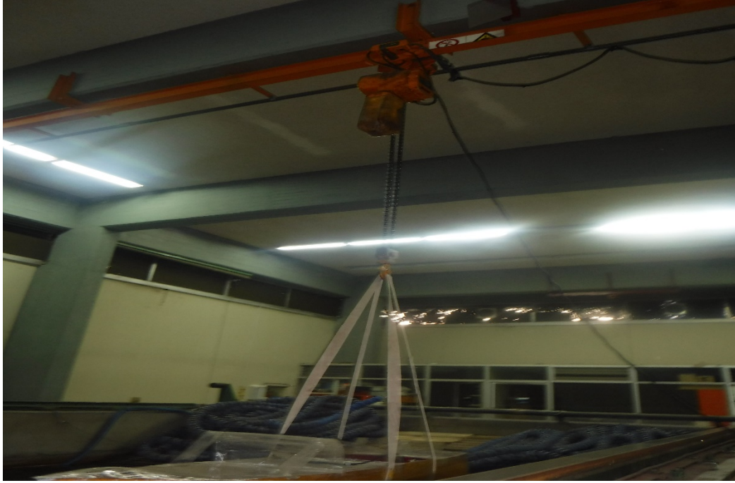
Εικόνα 3.2: Ο γερανός στην αρχή της δεξαμενής
