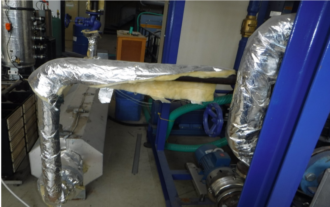
Εικόνα 4.24: Κατεστραμμένη επενδυτική μόνωση σωλήνα
