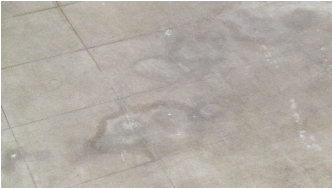
Εικόνα 4.17: Συγκέντρωση υδάτων στο δάπεδο
