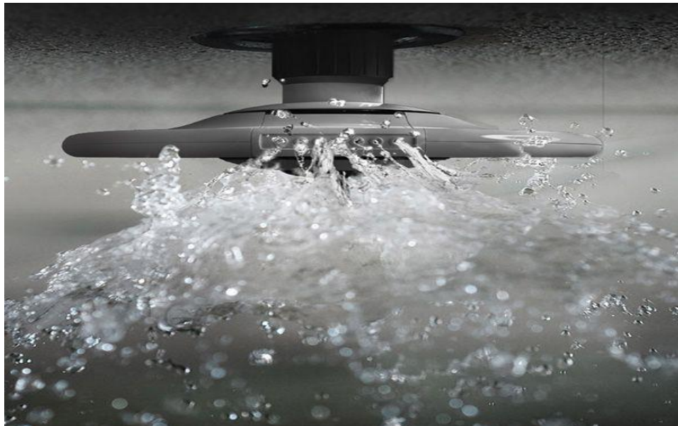
Εικόνα 15: Καταιονητήρας νερού μετά την ανίχνευση φωτιάς 14 .
