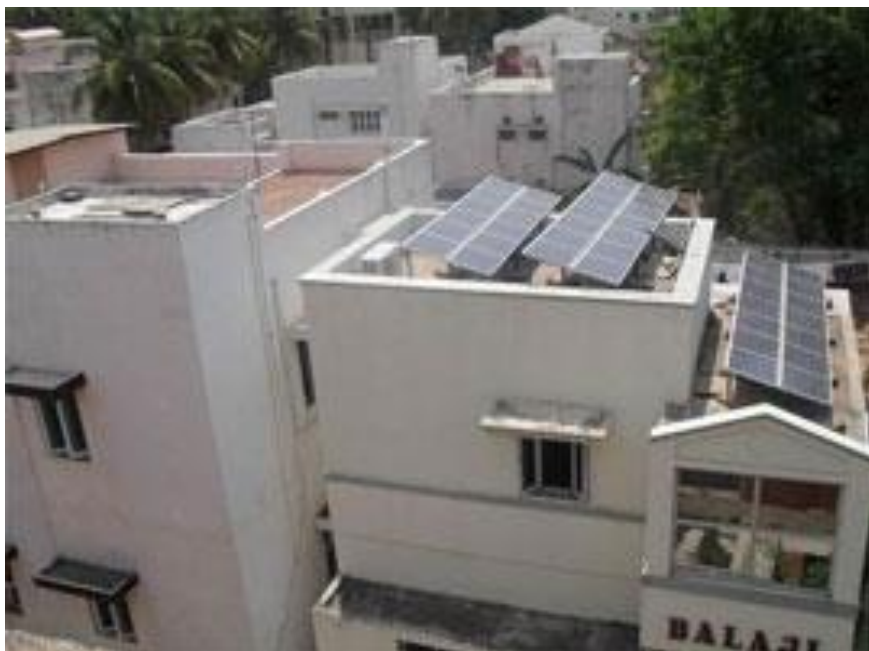
Εικόνα 1 Φ/Β πλαίσιο σε στέγη
