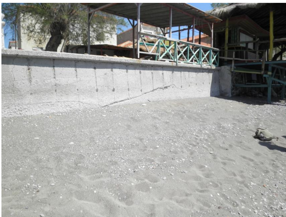
Εικόνα 4.12 : Ο θαλάσσιος τοίχος στη σημερινή του κατάσταση (1/4) (Τσομπανέλλης Θ., Απρίλιος 2015)
