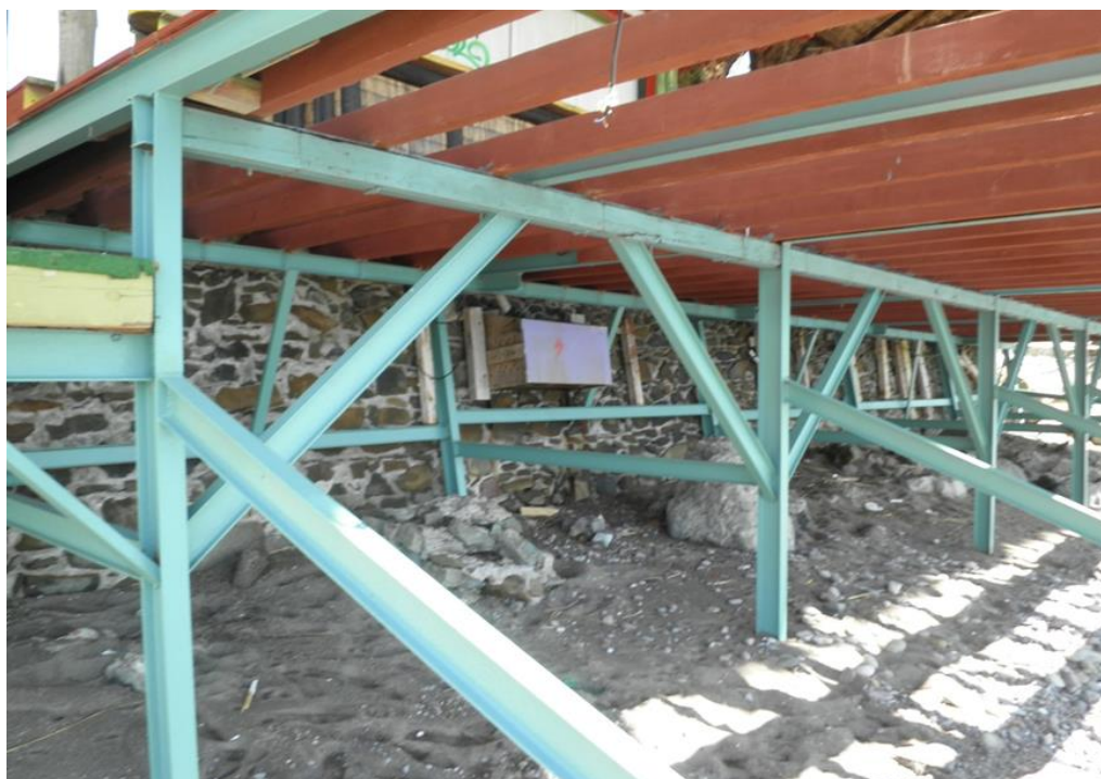
Εικόνα 4.13 : Ο θαλάσσιος τοίχος στη σημερινή του κατάσταση (2/4) (Τσομπανέλλης Θ., Απρίλιος 2015)
