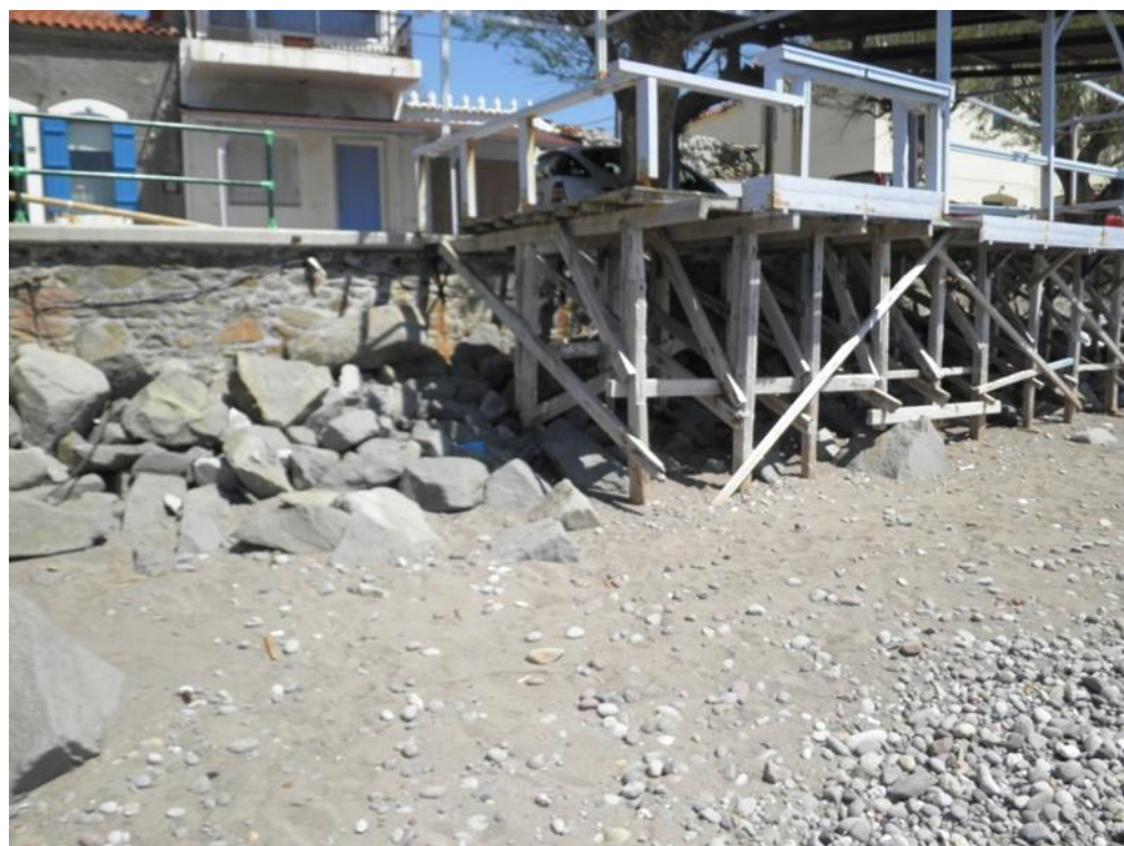
Εικόνα 4.14 : Ο θαλάσσιος τοίχος στη σημερινή του κατάσταση (3/4) (Τσομπανέλλης Θ., Απρίλιος 2015)
