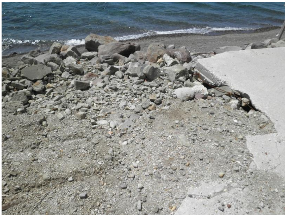
Εικόνα 4.7 : Τοπική αστοχία του τοίχου προστασίας (Τσομπανέλλης Θ., Απρίλιος 2015)
