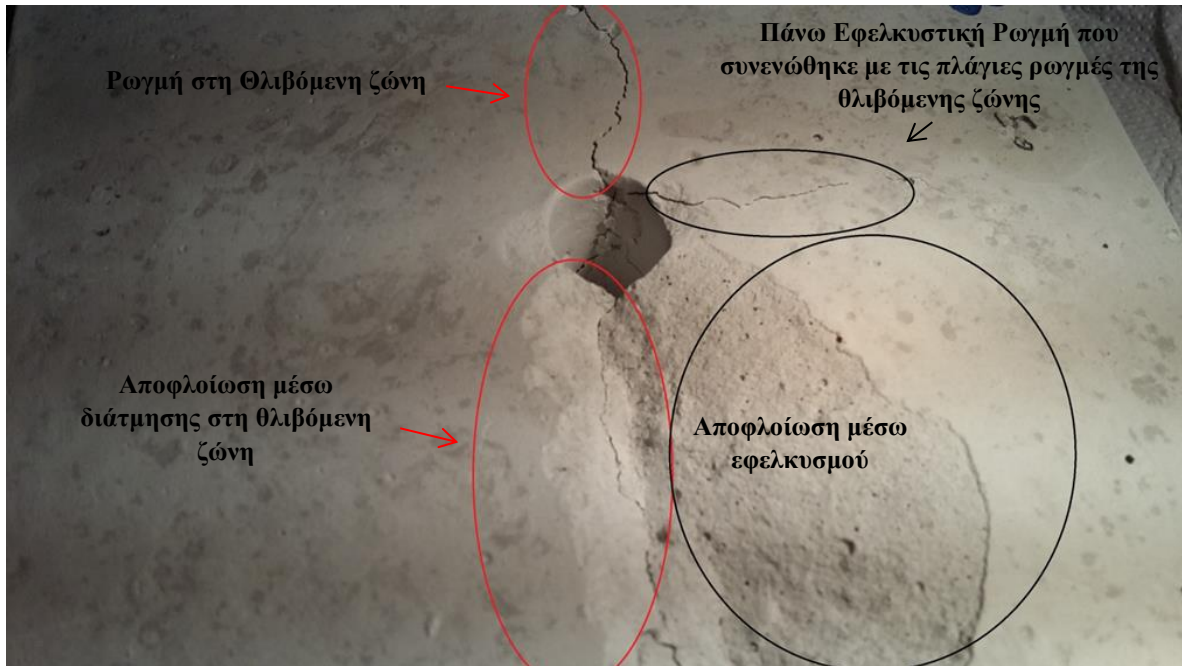
Εικόνα 56 - Ρωγμάτωση του δοκιμίου
