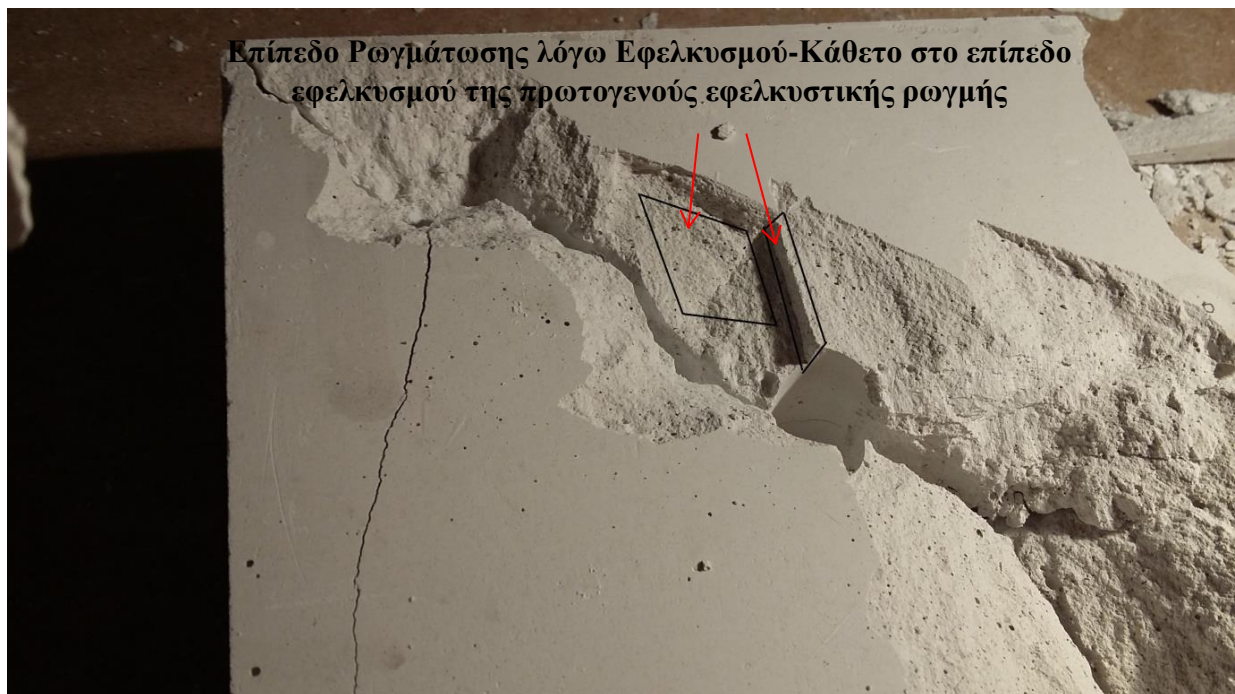
Εικόνα 55 - Δευτερογενές επίπεδο ρωγμάτωσης της πλάκας
