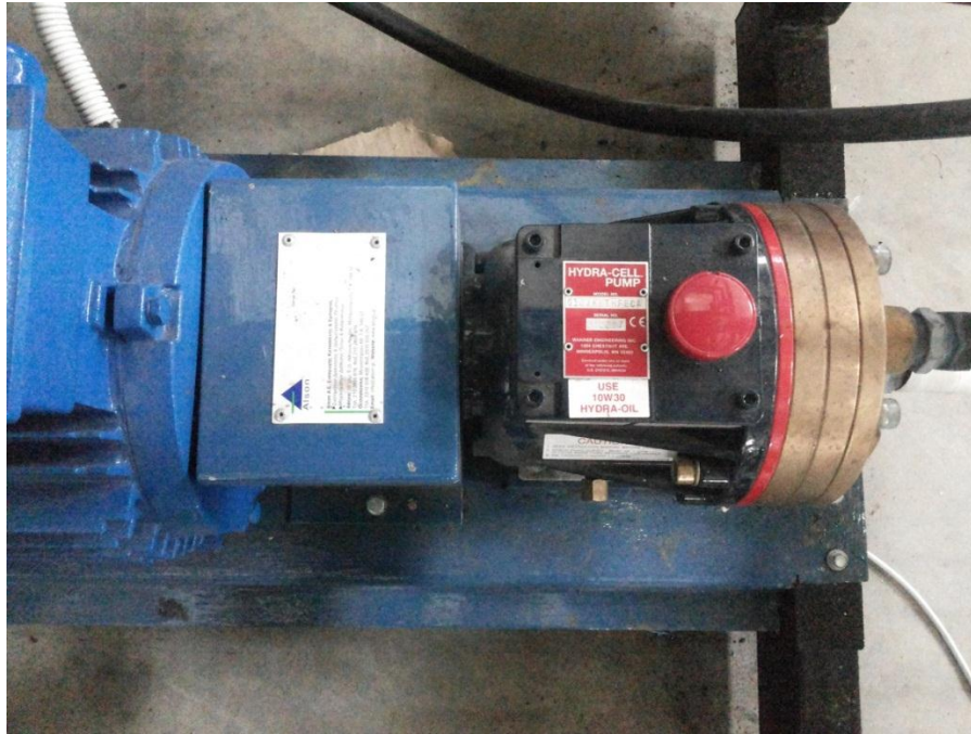
Εικόνα 3.3.2: Εγκατεστημένη αντλία στην εργαστηριακή διάταξη
