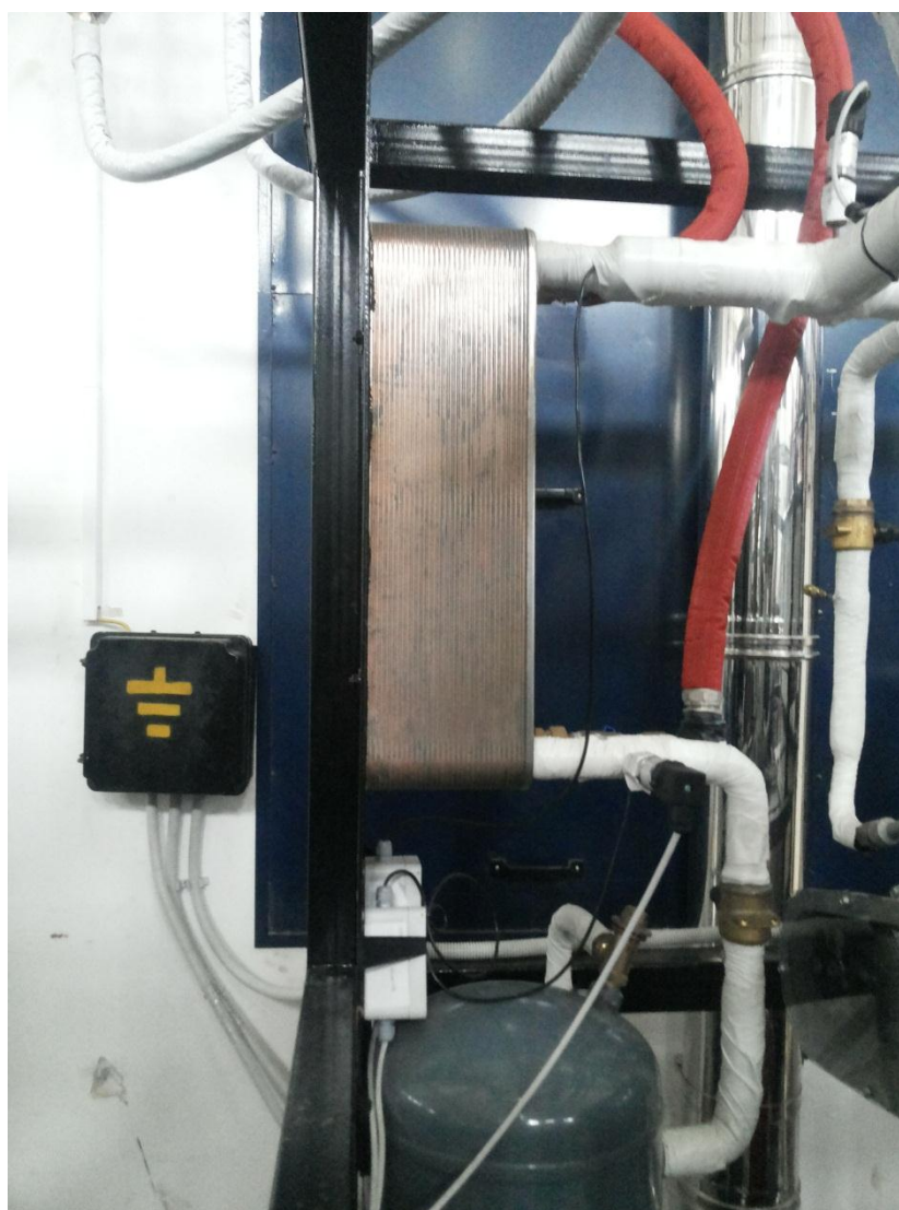
Εικόνα 3.5.1: Εγκατεστημένος συμπυκνωτής στο κύκλωμα ORC
