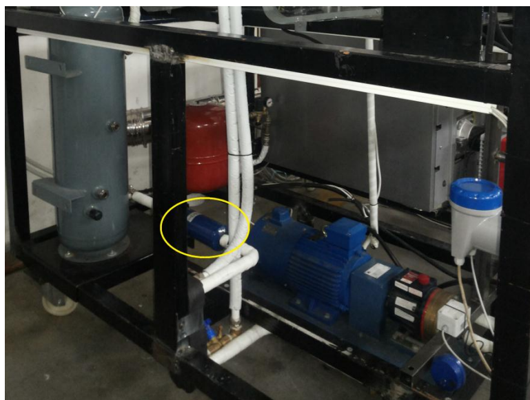
Εικόνα 3.6.3: Εγκατεστημένο φίλτρο στο κύκλωμα ORC
