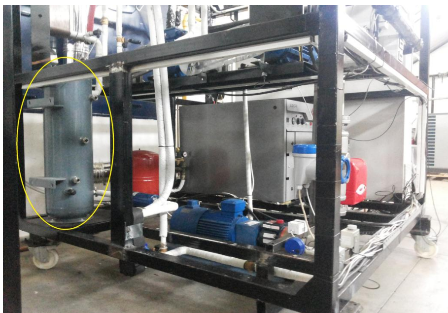
Εικόνα 3.6.1: Εγκατεστημένος συλλέκτης στο κύκλωμα ORC
