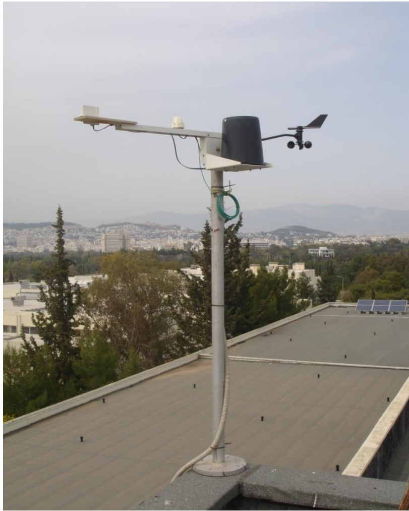
Σχήμα 2.1: Μετεωρολογικός Ιστός Davis Instruments εγκατεστημένος στο κτίριο ΑΝΥΜ,ΕΜΠ
