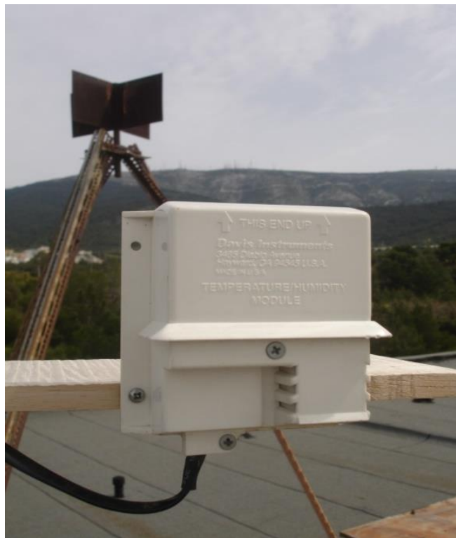
Σχήμα 2.6: Αισθητήρας μέτρησης θερμουγραμετρικών συνθηκών εγκατεστημένος στο κτίριο ΑΝΥΜ,ΕΜΠ
