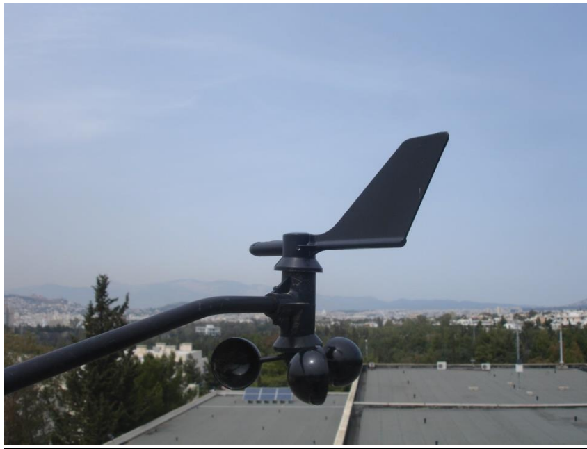
Σχήμα 2.7: Ανεμόμετρο και ανεμοδείκτης μετεωρολογικού ιστού εγκατεστημένο στο κτίριο ΑΝΥΜ,ΕΜΠ
