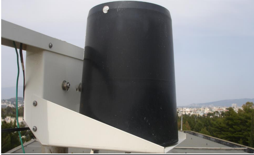
Σχήμα 2.2: Βροχόμετρο μετεωρολογικού σταθμού εγκατεστημένου στο κτίριο ANΥΜ, ΕΜΠ
