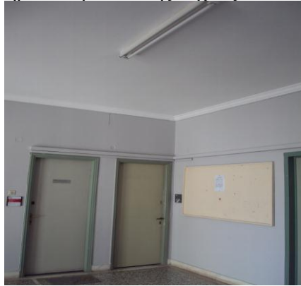
Εικόνα 5.6: Χρήση φωτιστικού με λαμπτήρα T8.
