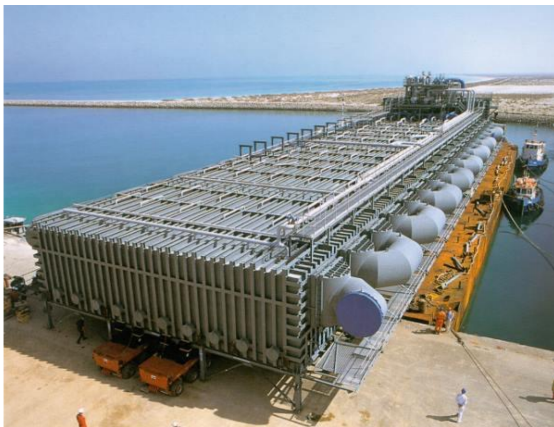
Εικόνα 1.1: Μονάδα αφαλάτωσης και διάθεσης αλμολιπού (desalination plant).
