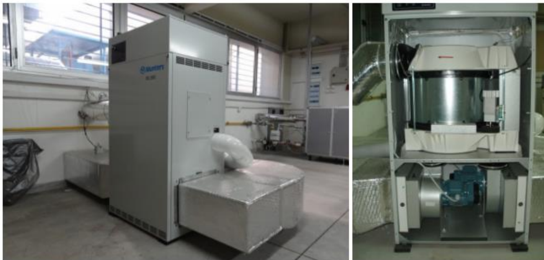
Εικόνα 1.2-2: Φωτογραφία συστήματος ψύξης και αφύγρανσης στερεού προσροφητικού μέσου της Σχολής Μηχανολόγων Μηχανικών ΕΜΠ 5
