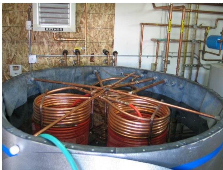
Εικόνα 3.3-10: Εσωτερικές σωληνώσεις σε δοχείο θερμικής αποθήκευσης
