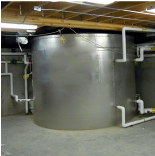
Εικόνα 3.3-8: Δοχείο θερμικής αποθήκευσης εντός κτιρίου
