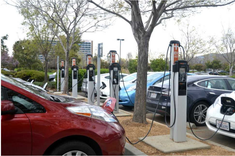
Εικόνα 1. 8 Χώρος στάθμευσης εξοπλισμένος με φορτιστές τριφασικής παροχής
