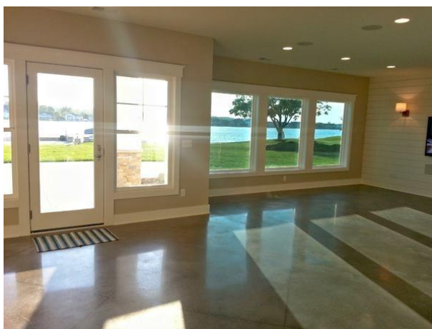
Σχήμα 4.16: Θερμοχρωμικοί υαλοπίνακες Suntuitive® εγκατεστημένοι στην δεξιά πλευρά του χώρου.
