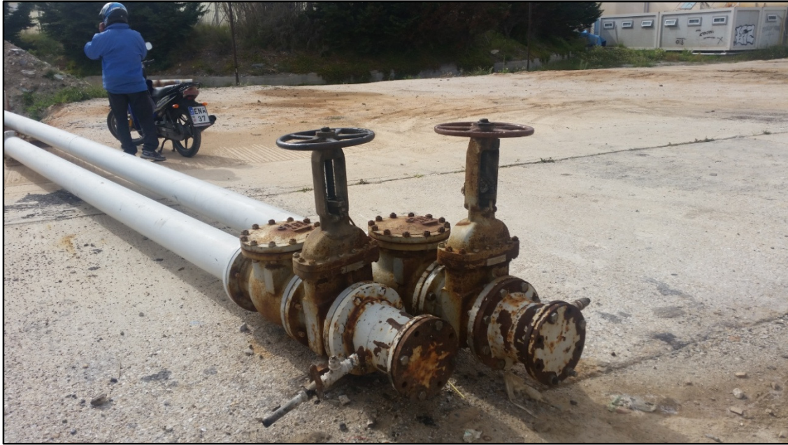
Εικόνα 29: Αγωγοί άντλησης καυσίμων
