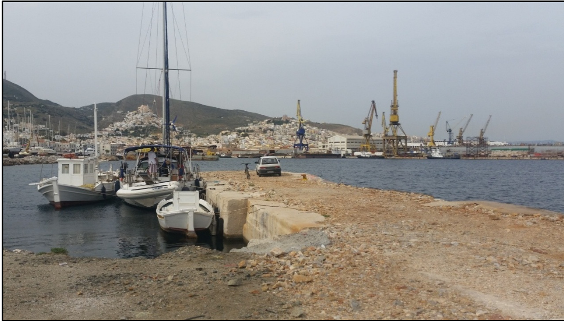
Εικόνα 27: Βόρειο μέρος εμπορικού κρηπιδώματος όπου φαίνεται η προχειρότητα κατασκευής του
