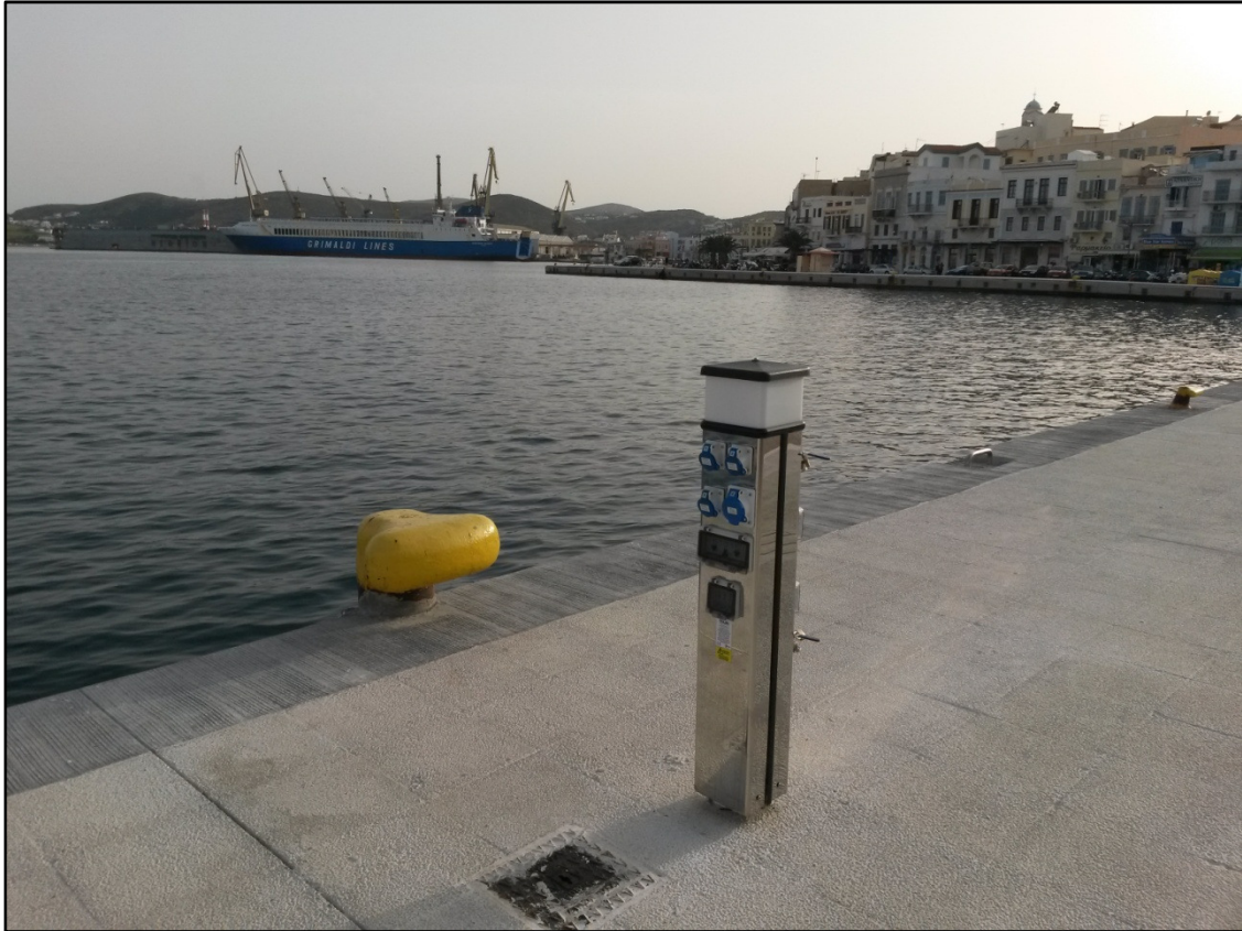
Εικόνα 5: Pillar ηλεκτροδότησης και υδροληψίας
