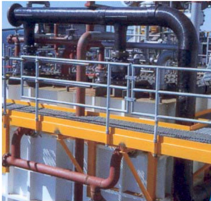
Σχήμα 1.6: Σωλήνωση GRE της AMERON σε πλατφόρμα άντλησης πετρελαίου
