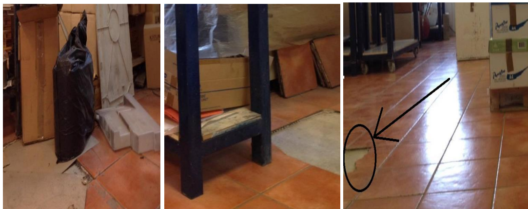
Εικόνες 4.8 – Φθορές δαπέδου στην Εκτυπωτική Μονάδα
