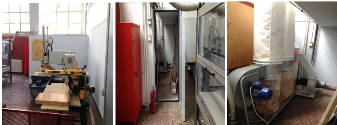
Εικόνες Β.2.8 – Κουβούκλιο αναρροφήσεων (γενική άποψη – είσοδος στο κουβούκλιο – σκούπες αναρρόφησης)
