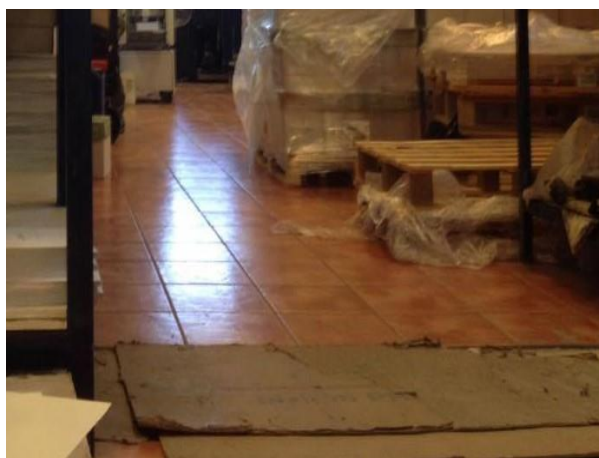
Εικόνα 4.9 – Αντιμετώπιση φθορών δαπέδου στην Εκτυπωτική Μονάδα
