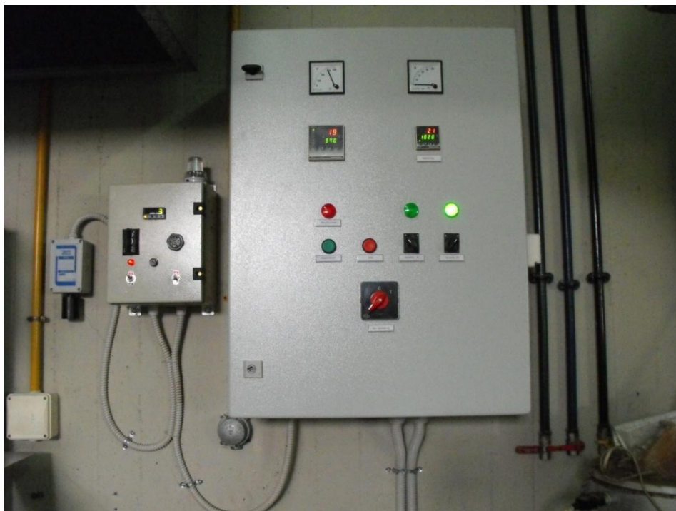
Εικόνα 30. Πίνακας ελέγχου-χειρισμού λειτουργίας καμινιού (δεξιά) Σύστημα ανίχνευσης CO (αριστερά)
