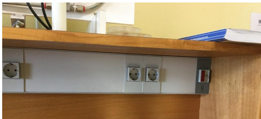
Εικόνα 3.25 Πάγκος εργαστηρίου με τη γραμμή μεταφοράς και το διακόπτη
