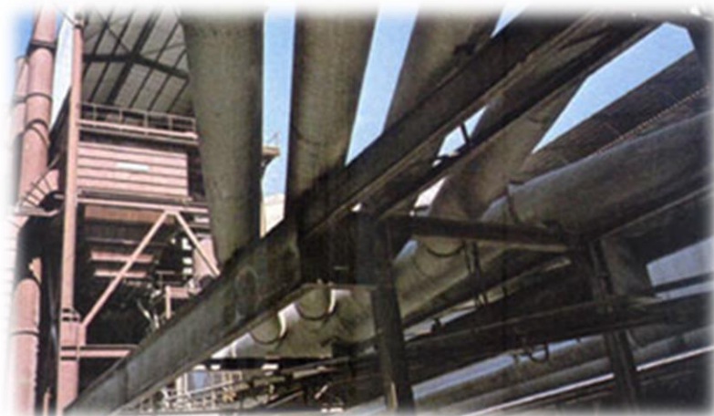
Εικόνα 6:Κέντρο επεξεργασίας των αερίων
