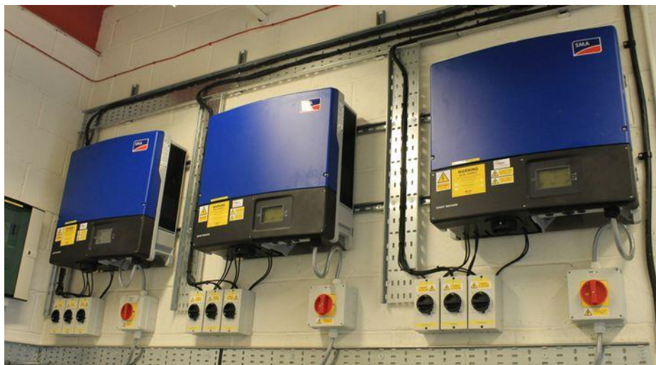
Εικόνα 2.6 : Μετατροπείς (inverters) σε εγκατάσταση Φ/Β [30]
