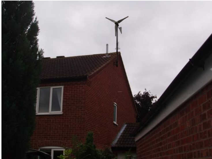
Εικόνα 2.11 : Οικιακή Α/Γ τοποθετημένη στην οροφή κτιρίου [23]
