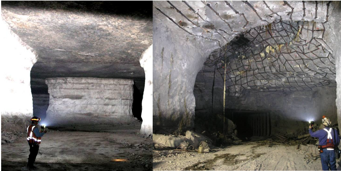
Εικόνα 4.1 Ευσταθής οροφής υπογείου θαλάμου (αριστερά) και ασταθής υπόγειος θάλαμος (δεξιά) που έχει υποστεί κατάπτωση οροφής (Esterhuizen et al., 2007)
