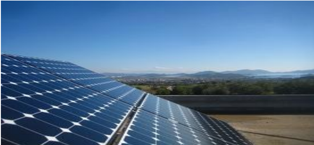
Εικόνα 5.2 : Φωτοβολταϊκή συστοιχία (Πηγή: https://www.mp-energy.gr )
