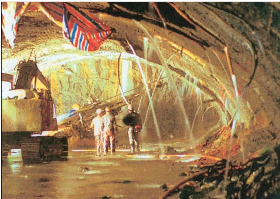
Εικόνα 1-3 Εισροή υδάτων σε σήραγγα υπό κατασκευή (Μαρίνος 2009)
