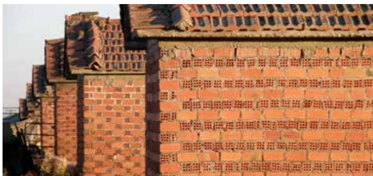
Εικ. 22-24. Τα «Μεγδοβίτικα» στο χωριό Ορφανά Καρδίτσας (έργο των Μ.Ο.Μ.Α. και του Αθανάσιου Ρουσόπουλου): Ένας από τους ελάχιστους συνολικά σχεδιασμένους οικισμούς της περιοχής και μια από τις πρώτες εφαρμογές αντισεισμικής τοιχοποιίας και σύγχρονων υλικών σε αγροκίες του Θεσσαλικού Κάμπου.
