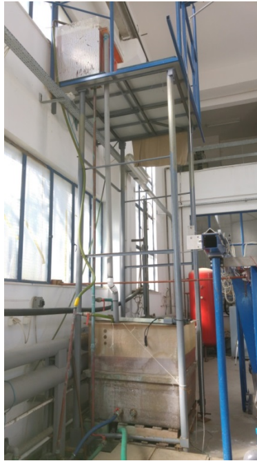
Σχήμα 3-4: Δεξαμενή παρασκευής διαλύματος (κάτω) & δεξαμενή τροφοδοσίας (άνω)
