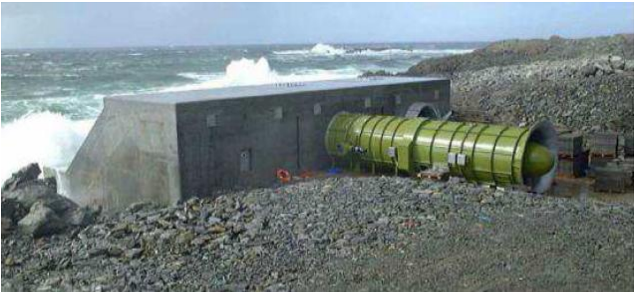
Εικόνα 1.14 - Εγκατάσταση παραγωγής ηλεκτρικής ενέργειας LIMPET στο νησί Islay της Σκωτίας
