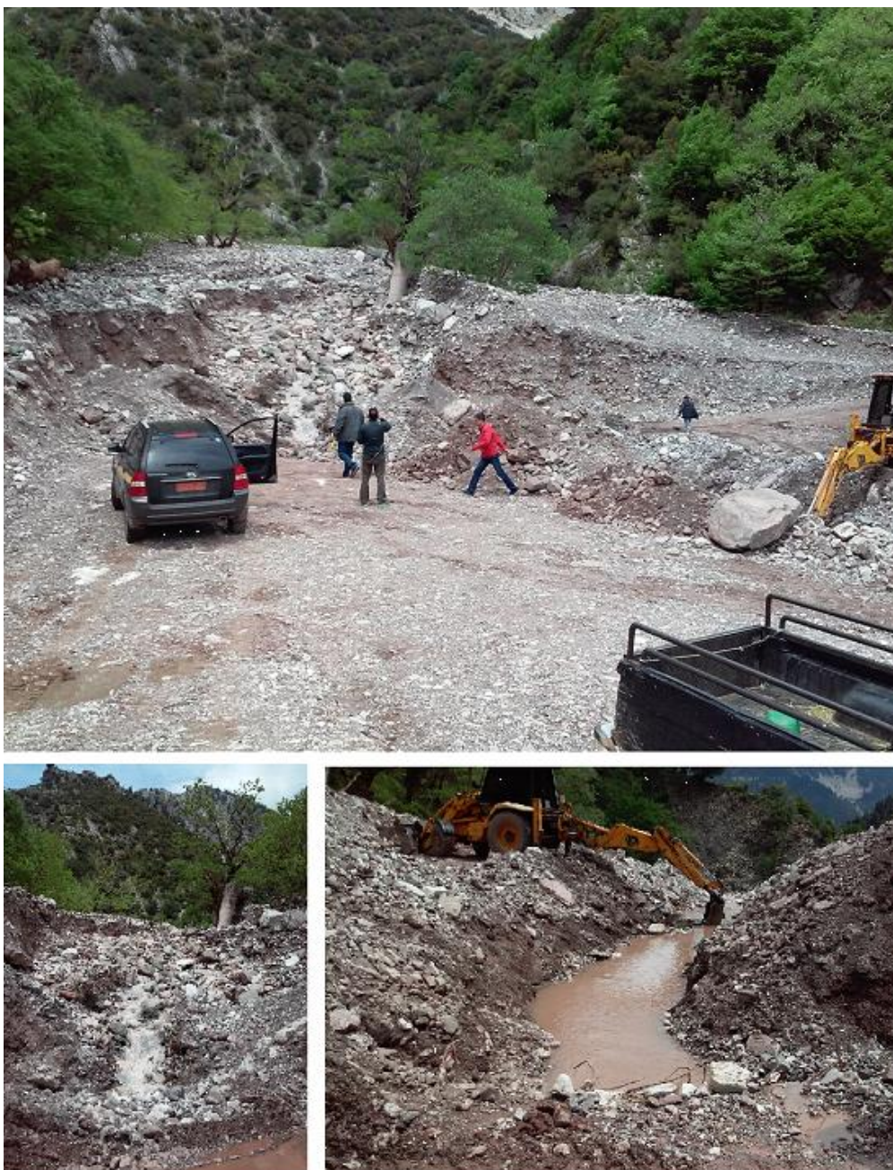
Εικόνα 4.24 Επίχωση της γέφυρας που δίνει πρόσβαση στο Αργυρό Πηγάδι νοτιοδυτικά μέσω του οικισμού της Αμβρακίας.
