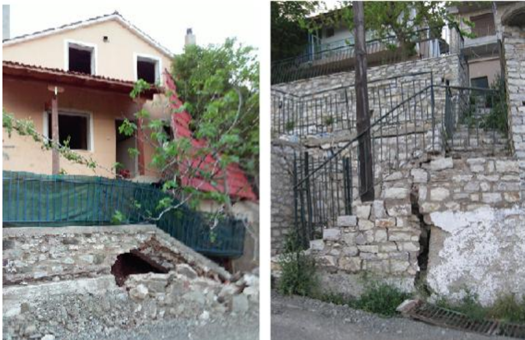
Εικόνα 4.14: Εκτεταμένες ζημιές σε οικίες που αναγνωρίζονται εντός της μάζας ολίσθησης, πλησίον της στέψης της μετατεθειμένης προς τα ανάντη κύριας ολίσθησης (θέση ΚΛ1β).
