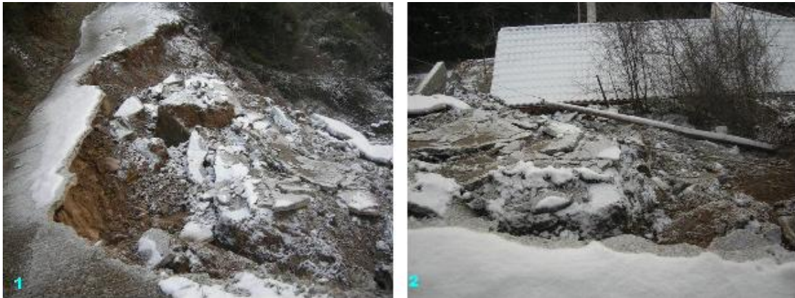
Εικόνα 4.19: Άποψη της κατολίσθησης στη Θέση 3. Η εικόνα (1) δείχνει την αποκοπή του δημοτικού δρόμου στην κορυφή της κατολίσθησης. Στην εικόνα (2) φαίνεται η μετακίνηση και η συσσώρευση των υλικών της κατολίσθησης στο πίσω μέρος της κατάντη ευρισκόμενης κατοικίας. (Κωνσταντοπούλου & Κανάρης, 2015).
