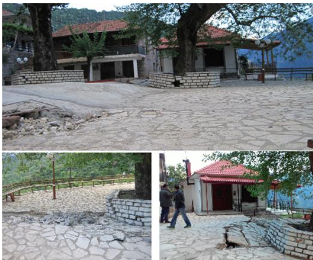
Εικόνα 4.15: Αναγνώριση της στέψης της μετατεθειμένης προς τα ανάντη κύριας ολίσθησης (θέση ΚΛ1γ) επί της κεντρικής πλατείας του οικισμού.
