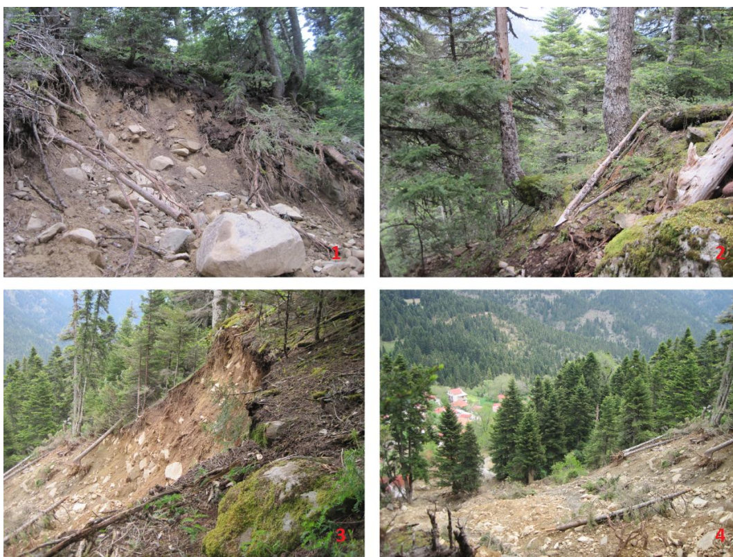
Εικόνα: 4.41 Άποψη της στέψης της κατολίσθησης (εικόνα 1 & 3). Φαινόμενα ερπυσμού στην ευρύτερη περιοχή της στέψης της κατολίσθησης (εικόνα 2). Άποψη του οικισμού της Άμπλιανης από τη στέψη της κατολίσθησης.
