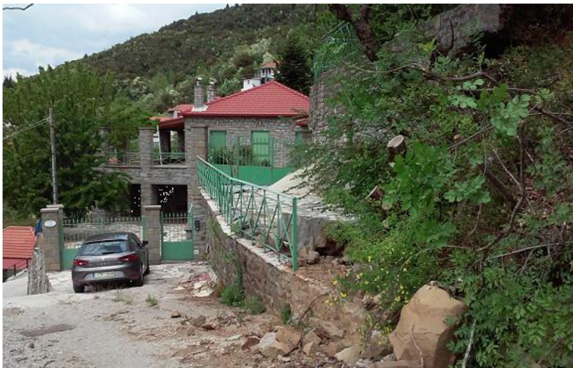
Εικόνα 4.3 Άποψη της οικίας στην οποία καταγράφηκε η κατολίσθηση στη θέση ΠΕ1. Παρατηρούνται ζημιές στον τοίχο αντιστήριξης.
