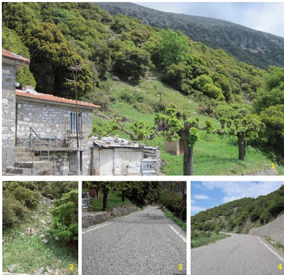
Εικόνα 4.20: Καταγραφείσες κατολισθήσεις επί της Επ. Οδού Ναυπάκτου – Πλατάνου – Ψηλού Σταυρού στις θέσεις 1 (εικόνες 1,2 & 3) και θέση 2 (εικόνα 4).
