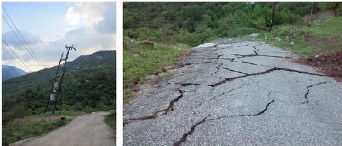
Εικόνα 4.13: Εφελκυστικές ρωγμές ανάντη του δεξιού πρανού της κατολίσθησης (Δεξιά). Παρατηρούνται εκτεταμένες καταστροφές στο οδόστρωμα και τους στύλους ηλεκτρικού ρεύματος (Αριστερά).
