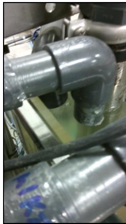
Σχήμα 4.19: Σωλήνωση για την προσθήκη διαλύματος σόδας (MBR1 και MBR2)
