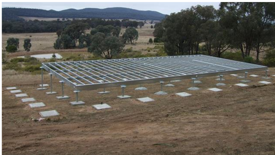
Σχήμα 1.5: Ολοκληρωμένη θεμελίωση πριν την τοποθέτηση της ανωδομής από βασικές μονάδες. Οι ελικοειδής πάσσαλοι έχουν τοποθετηθεί προηγουμένως σύμφωνα με την στατική μελέτη, ενώ συνδέονται μεταξύ τους με μεταλλικές διατομές θερμής και ψυχρής έλασης.
