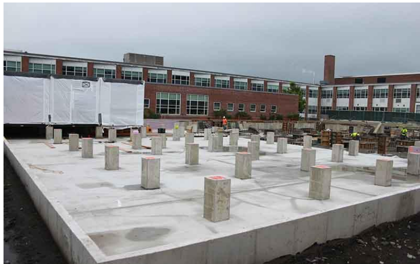
Σχήμα 1.4: Τυπικό έργο με πλάκα οπλισμένου σκυροδέματος, στην οποία έχουν τοποθετηθεί τα προκατασκευασμένα μπλοκ σε καθορισμένες θέσεις και αποστάσεις.
