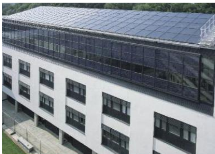
Σχήμα 4.10: Εγκατάσταση φωτοβολταϊκών στη στέγη νοσοκομείου [80]
