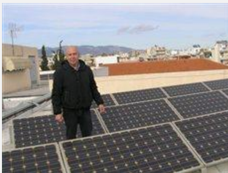
Εικόνα 37_Φωτοβολταικα πάνελ στην οροφή σχολείου ( econews.gr )
