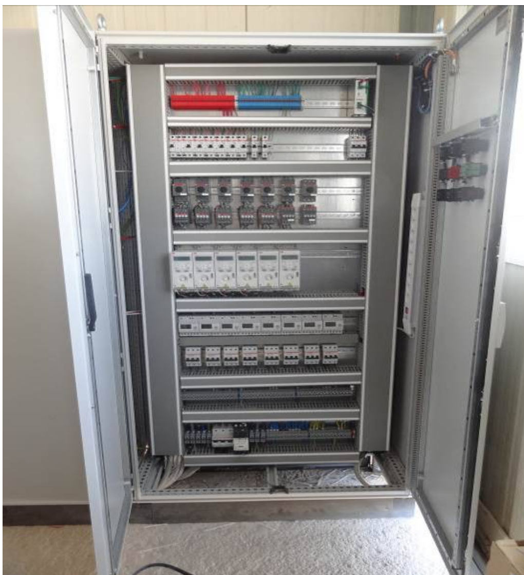
Εικόνα 3.7 Πίνακας διανομής στο τεχνικό δωμάτιο
