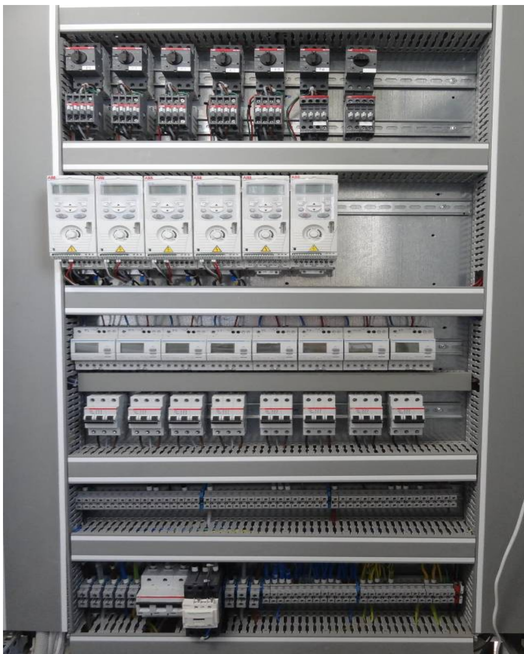
Εικόνα 3.6 Μετρητές ηλεκτρικής ενέργειας στον κεντρικό ηλεκτρικό πίνακα
