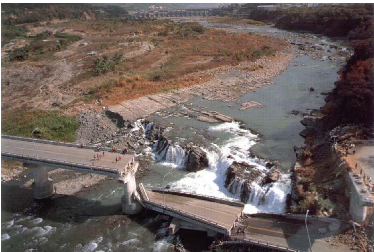
Εικόνα 2.6: Γέφυρα στον ποταμό Ta-Chia που κατέρρευσε, λόγω κατακόρυφης τεκτονικής μετατόπισης 5 μέτρων, κατά το σεισμό του 1999 στο Chi-Chi της Taiwan. (από Faccioli et al., 2008)
