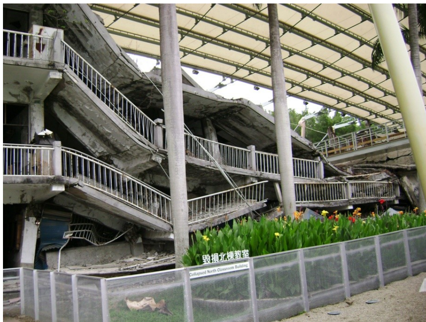
Εικόνα 2.5: Σχολή kung-fu που κατέρρευσε λόγω τεκτονικής μετακίνησης, κατά το σεισμό του 1999 στο Chi-Chi της Taiwan. (φωτογραφία από το μουσείο 921 Earthquake Museum στο Taichung της Taiwan)
