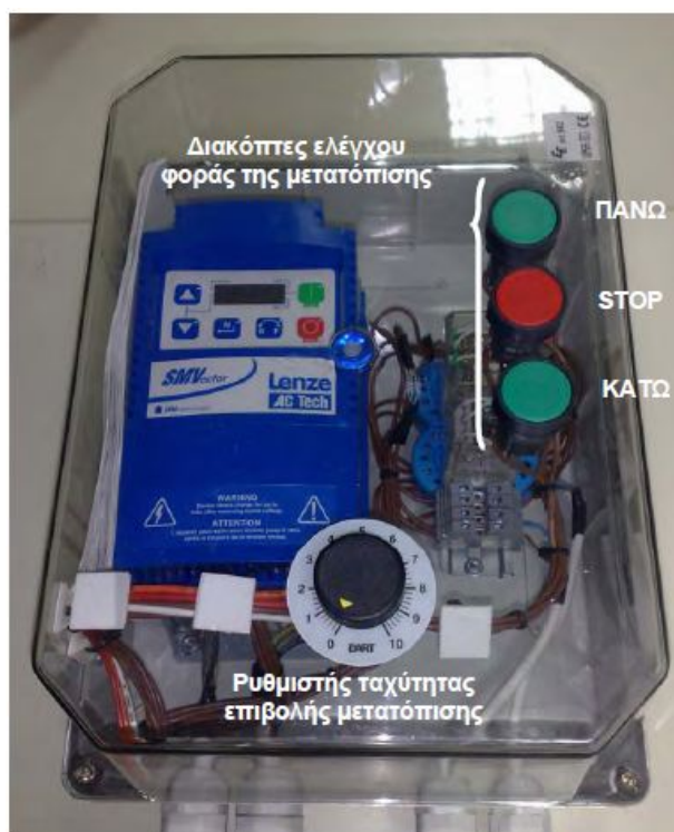
Εικόνα 6.3: Πίνακας ελέγχου της Πειραματικής Διάταξη Προσομοίωσης Σεισμικής Διάρρηξης. Διακρίνονται τα κουμπιά ελέγχου της φοράς της επιβαλλόμενης μετακίνησης, καθώς και ο ρυθμιστής επιβολής της μετακίνησης.
