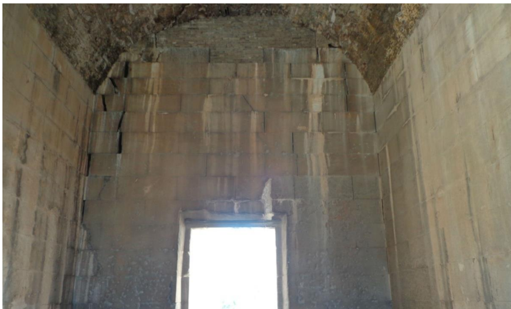
Εικόνα 31: Ρωγμή δυτικού τοίχου.
