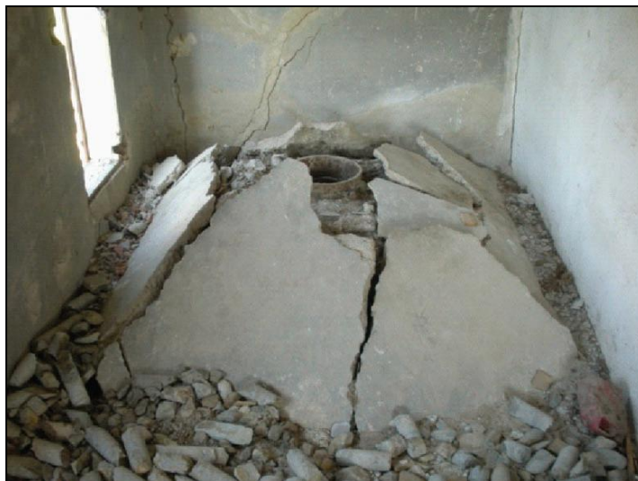
Εικόνα 2.3: Ανάδυση της σωλήνωσης γεώτρησης, ΒΔ του Καλοχωρίου, εξαιτίας των εδαφικών υποχωρήσεων (Loupasakis et al., 2013).
