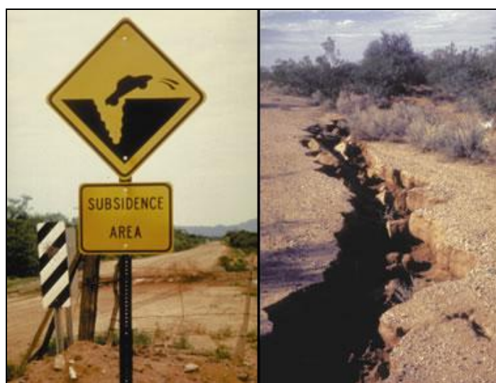
Εικόνα 2.2: Προειδοποιητικό σήμα κινδύνου εδαφικής υποχώρησης, το οποίο τοποθετήθηκε μετά την εμφάνιση της διάρρηξης που κατέστρεψε τον δρόμο (δεξιά) (Water Science Photo Gallery, U.S.G.S).
