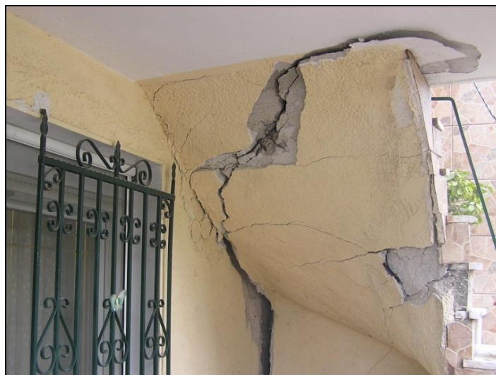
Εικόνα 2.5: Αποκολλήσεις πρόσθετης κατασκευής (σκάλας) σε οικία, όπου η εδαφική διάρρηξη διέρχεται αμέσως έξω από το χώρο θεμελίωσης αυτής (Koumantakis et. al., 2008).
