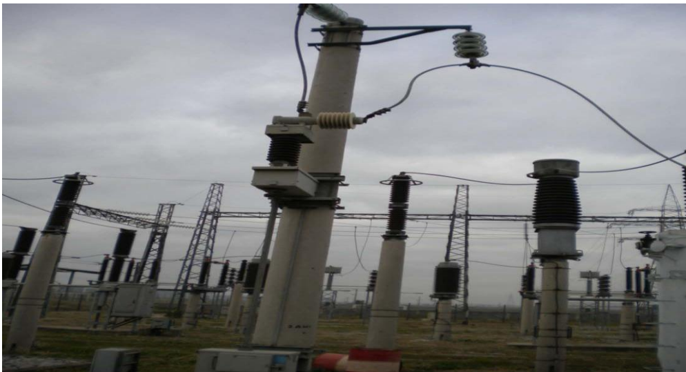
Εικόνα 15: Διακόπτης φορτίου 25 kV
