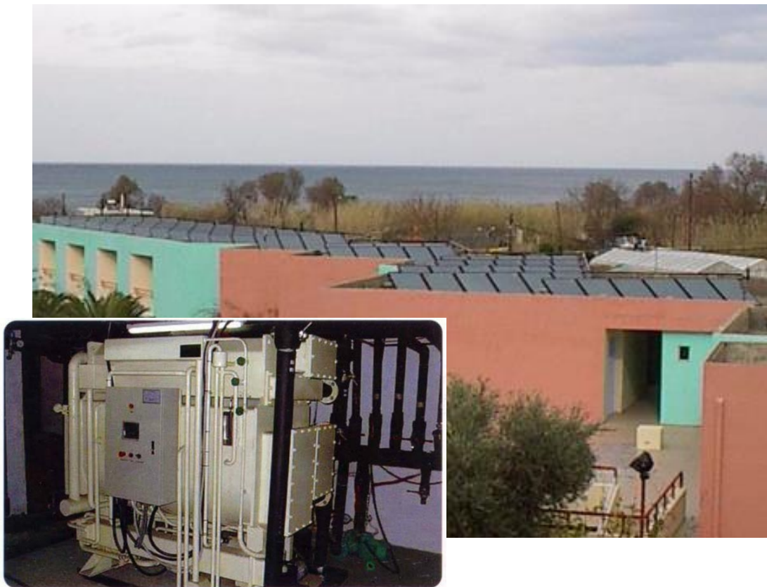
Εικόνα 2.16. Πεδίο ηλιακών συλλεκτών και ο ψύκτης απορρόφησης 105 kW, στο Rethymno Village Hotel στην Κρήτη [16]
