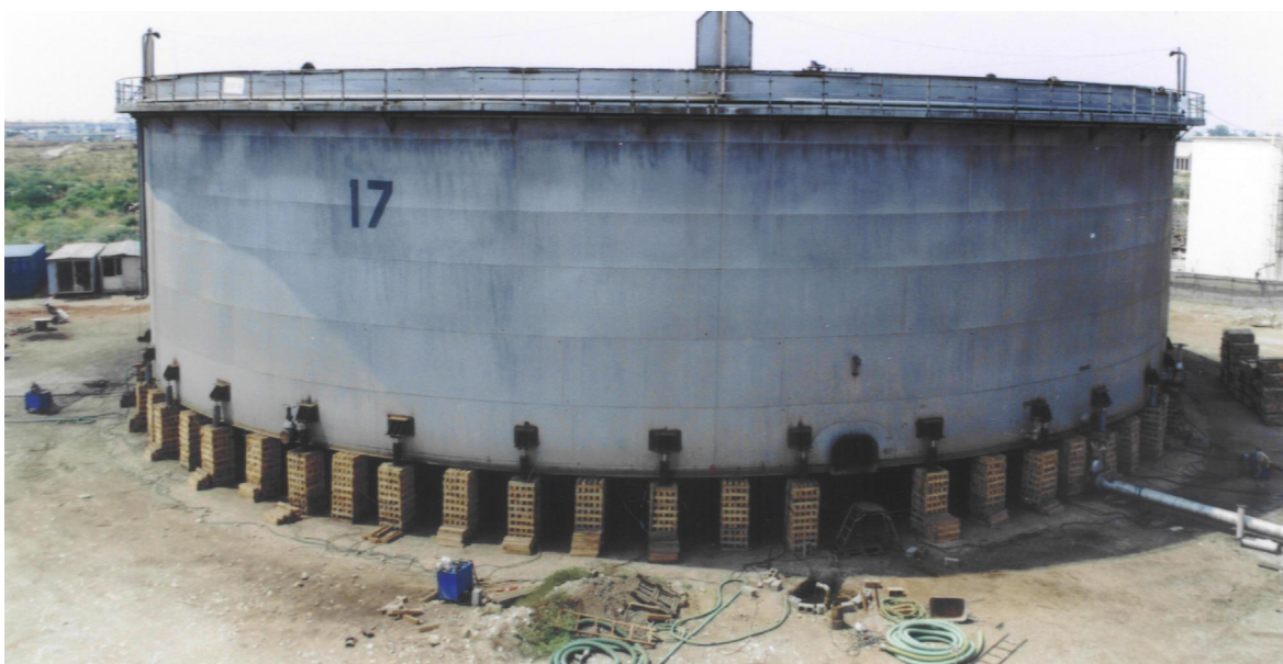
Σχήμα 1.1: Κυλινδρική, επίγεια, μεταλλική δεξαμενή αργού πετρελαίου στο Καλοχώρι Θεσσαλονίκης, Λαβασάς κ.α. (2005)
