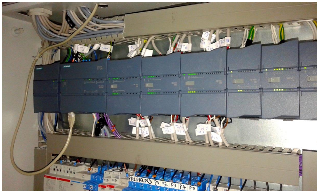
Σχήμα 32: Το PLC της εγκατάστασης
