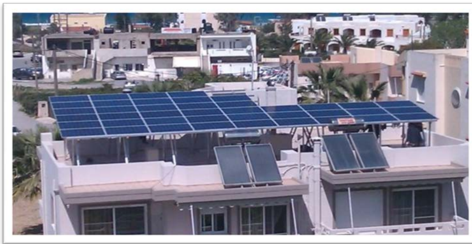
Εικόνα 3.3.3:Φωτοβολταϊκά συστήματα σε κατοικίες [14]
