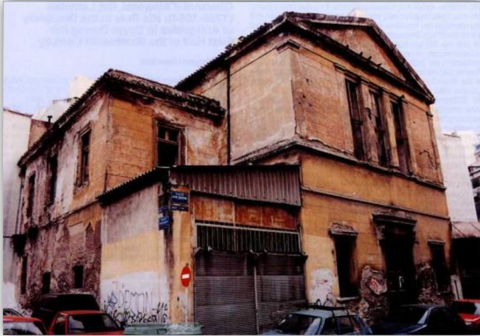
Εικόνα 7.8: Το κτίριο του Παλαιού Κακουργιοδικείου στην γωνία των οδών Α.Ελεούσης και Κακουργιοδικείου πριν την αποκατάσταση. Πηγή: Google ( www.google.gr ), Ιανουάριος 2016
