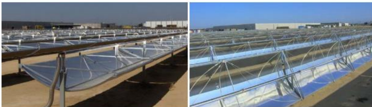
ΕΙΚΟΝΑ 5.4.2 ΟΙ ΠΑΡΑΒΟΛΙΚΟΙ ΣΥΛΛΕΚΤΕΣ ΣΤΟ ΕΡΓΟΣΤΑΣΙΟ FRITO LAY[39]
