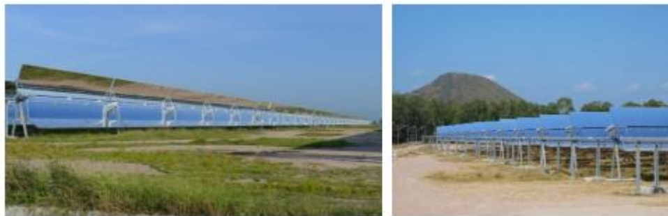
ΕΙΚΟΝΑ 5.4.5 ΕΙΚΟΝΕΣ ΑΠΟ ΤΗΝ ΕΓΚΑΤΑΣΤΑΣΗ THAI SOLAR ENERGY 1[39]
