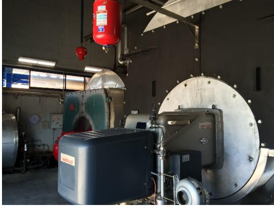
ΕΙΚΟΝΑ 3.2.1 ΟΙ ΔΥΟ ΑΤΜΟΛΕΒΗΤΕΣ ΤΗΣ ΝΟΥΝΟΥ ΣΤΟ ΛΕΒΗΤΟΣΤΑΣΙΟ. ΜΠΡΟΣΤΑ ΒΡΙΣΚΕΤΑΙ Ο ΡΚ-14000 ΚΑΙ ΠΙΣΩ Ο ΛΕΒΗΤΑΣ ΓΙΑ 7000ΚG/Η
