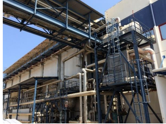
ΕΙΚΟΝΑ 3.2.2 ΤΟ ΚΥΚΛΩΜΑ ΣΩΛΗΝΩΣΕΩΝ ΓΙΑ ΤΗΝ ΜΕΤΑΦΟΡΑ ΑΤΜΟΥ
