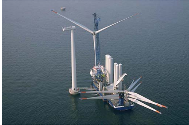
Σχήμα 14 Εγκατάσταση ανεμογεννήτριας σε αιολικό πάρκο στην Αγγλία Πηγή: http://www.progressive-charlestown.com
