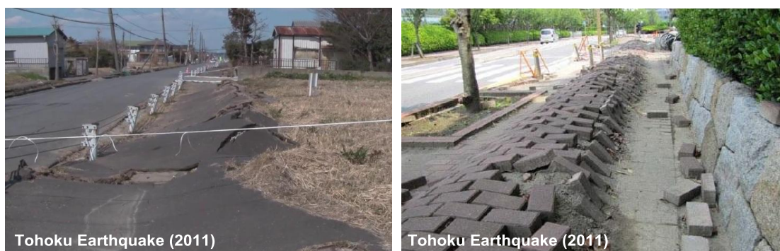
Σχήμα 1.1: Αστοχίες εγκιβωτισμένων αγωγών λόγω φαινομένων άνωσης σε ρευστοποιημένο έδαφος
