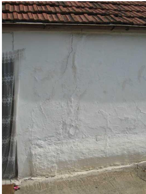
Εικόνα 2.4: Αστοχία σε τοίχο σπιτιού χτισμένο πάνω στο ρήγμα των Αναργύρων (Loupasakis 2014).
