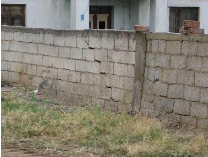
Εικόνα 2.3. Περίφραξη οικίας που βρίσκεται στο πεδινό τμήμα της περιοχής και έχει πληγεί από τις εδαφικές διαρρήξεις (μετατοπίσεις 3-10 cm) (Loupasakis, 2014).
