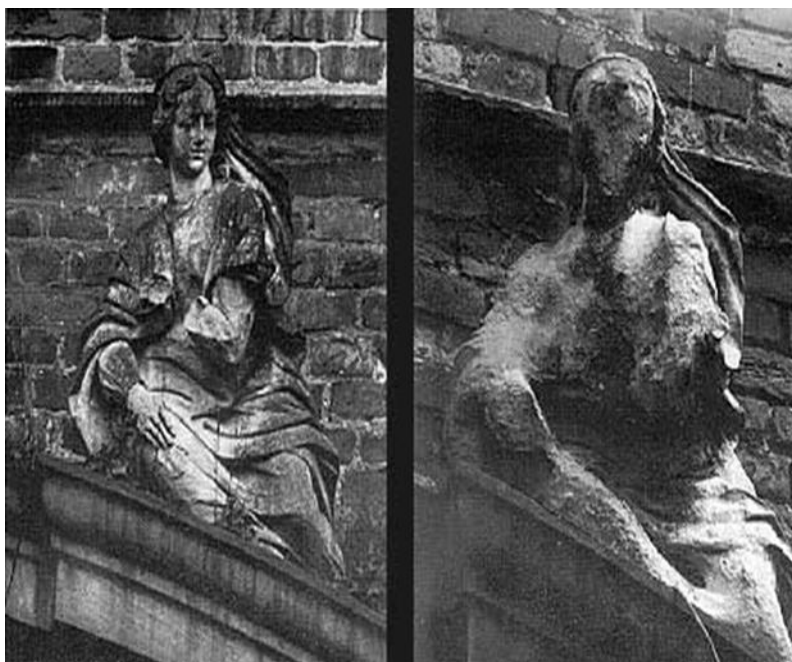
Εικόνα 2-2: Επιπτώσεις της όξινης βροχής σε γλυπτό στον πύργο Χέρτεν στη Βεσφαλία της Γερμανίας 1908 - 1969. [7]
